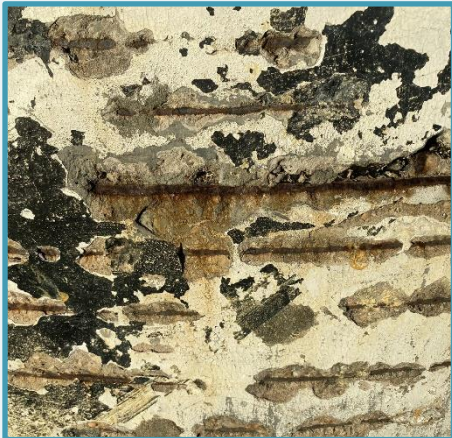
Desplacamento de revestimento
