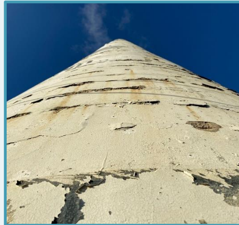
Desplacamento de revestimento
