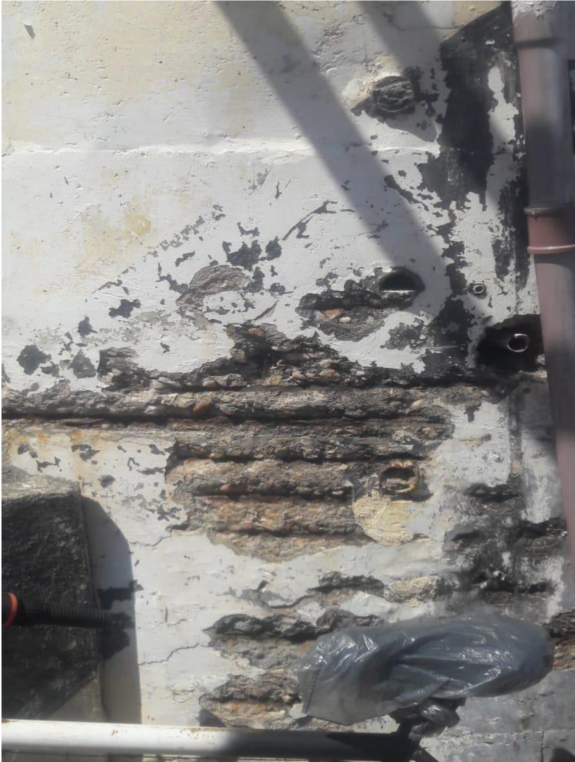
ÁREA DA BASE DO CASTELO, COM REDUÇÃO DO AÇO DAS CINTAS E DESGASTE DO REVESTIMENTO DE COBRIMENTO
