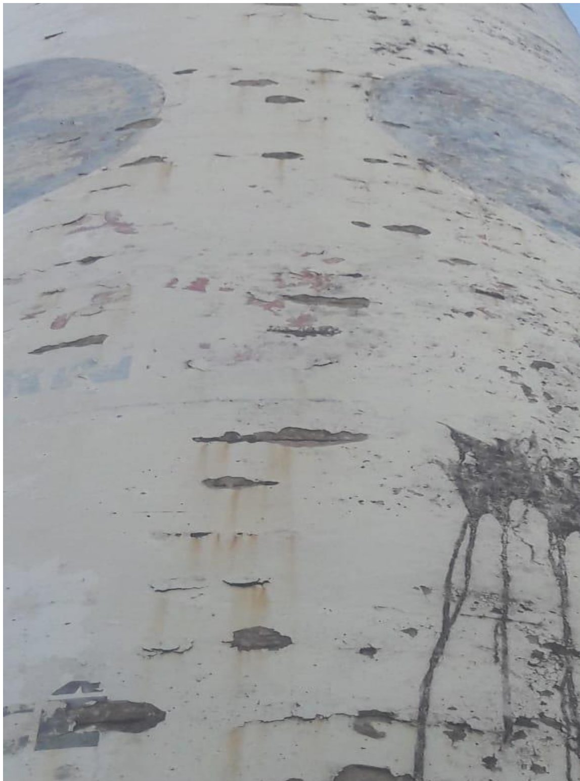
DESPLACAMENTO E INFILTRAÇÕES VISÍVEIS EM TODA EXTENSÃO DO CASTELO
